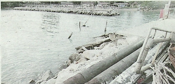
Keadaan benteng pemecah ombak yang didakwa dirosakkan oleh syarikat perkhidmatan bot di Melaka.
